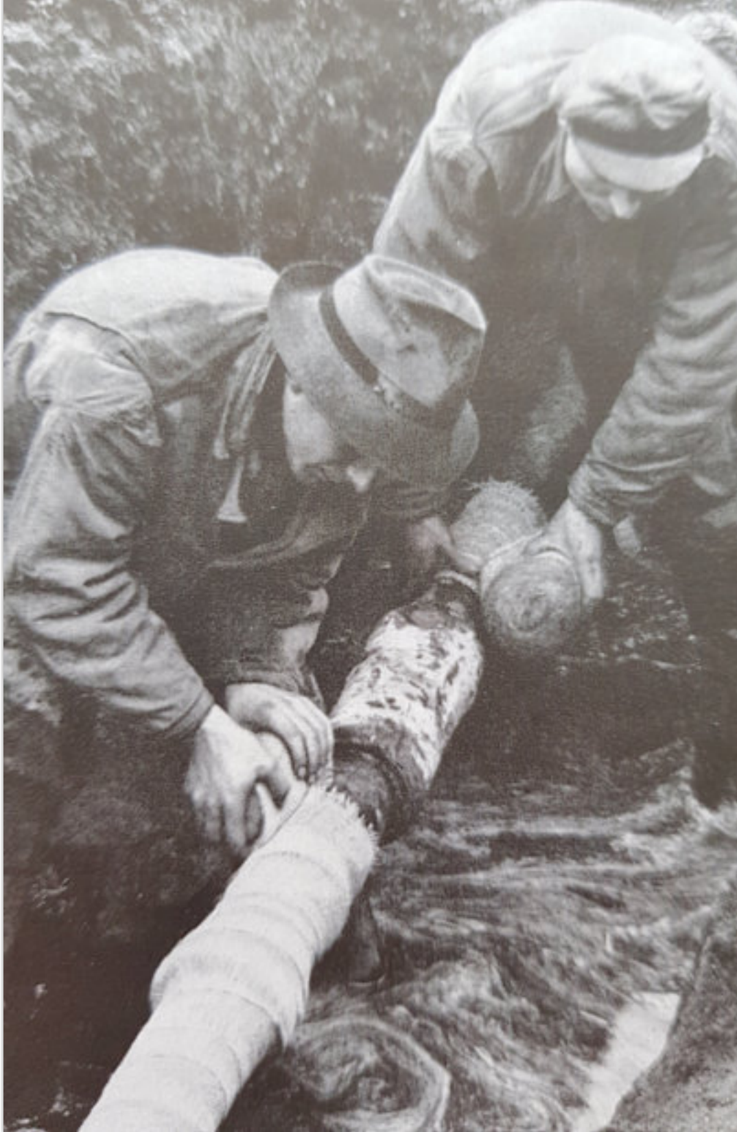
Durch Einwirkungen des Bergbaus entstanden Undichtigkeiten. Grundwasser erschwerte häufig die Arbeit der Rohrleger.
