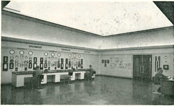
Schaltwarte im Zechenkraftwerk (über Tage). — Neben dem gewaltigen Eigenbedarf liefert das Zechenkraftwerk auch Energie in das öffentliche Netz.
