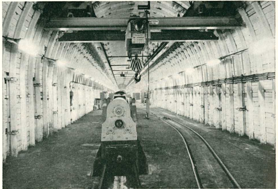
Auch das gibt es 850 m unter Tage: Ladestation für batteriegetriebene Grubenlokomotiven auf der 6. Sohle in der Nähe des Schachtes „Konrad Ende“.
