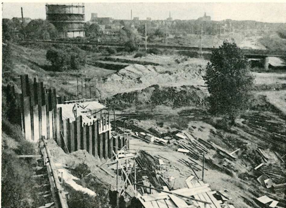
Mitten in der Bauausführung stecken die Arbeiten zur Durchführung des Verbindungsarmes Bundesstraße 51/Emscherschnellweg durch die Bundesbahnstrecke Herne—Recklinghausen. Unser Bild zeigt von einem Standort hoch über dieser Strecke aus diese Arbeiten mit der fertigen Brücke im Zuge der Köln-Mindener Strecke, mit den beginnenden Erdarbeiten für den Abfahrtsarm und mit den Einrichtungen für das Bauwerk zum Durchfahren der erwähnten Bundesbahnstrecke Herne—Recklinghausen.
