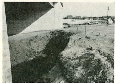
Hier ein Blick auf das östliche Widerlager der Brücke im Zuge der Eickeler Straße über die Bundesstraße 51 mit dem Beginn der Dammschüttungen zwischen diesem Bauwerk und dem ebenfalls schon fertiggestellten Bauwerk im Zuge der Überführung der Eickeler Straße über die Zechenbahn. In dem letztgenannten Bauwerk werden auch die Rohrleitungen zur Versorgung der Hibernia durchgeführt.
